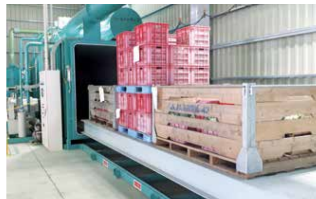
持ち込まれたコンテナのまま真空予冷する
