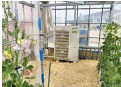
導入が進むヒートポンプ
